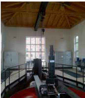
Wasserkraftwerk - Mühleninsel Merseburg
