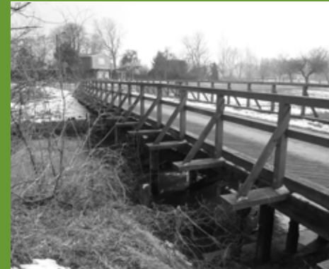
Die durch das Hochwasser beschädigte Brücke wurde im Mai 2015 abgerissen
